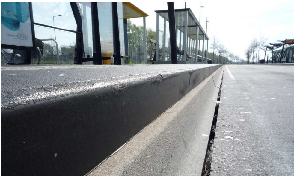
Figur 4-8. Kantstenens utformning möjliggör en noggrann nära angöring utan risk för skadade hjul.
