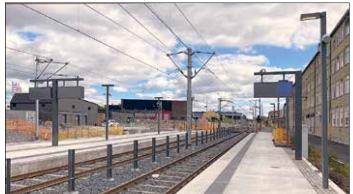
Norra Ulvsunda återöppnades den 1 augusti. Dock var hållplatsen då ännu inte helt färdig utan alltjämt delvis en byggarbetsplats. Foto: Martin Lindahl
