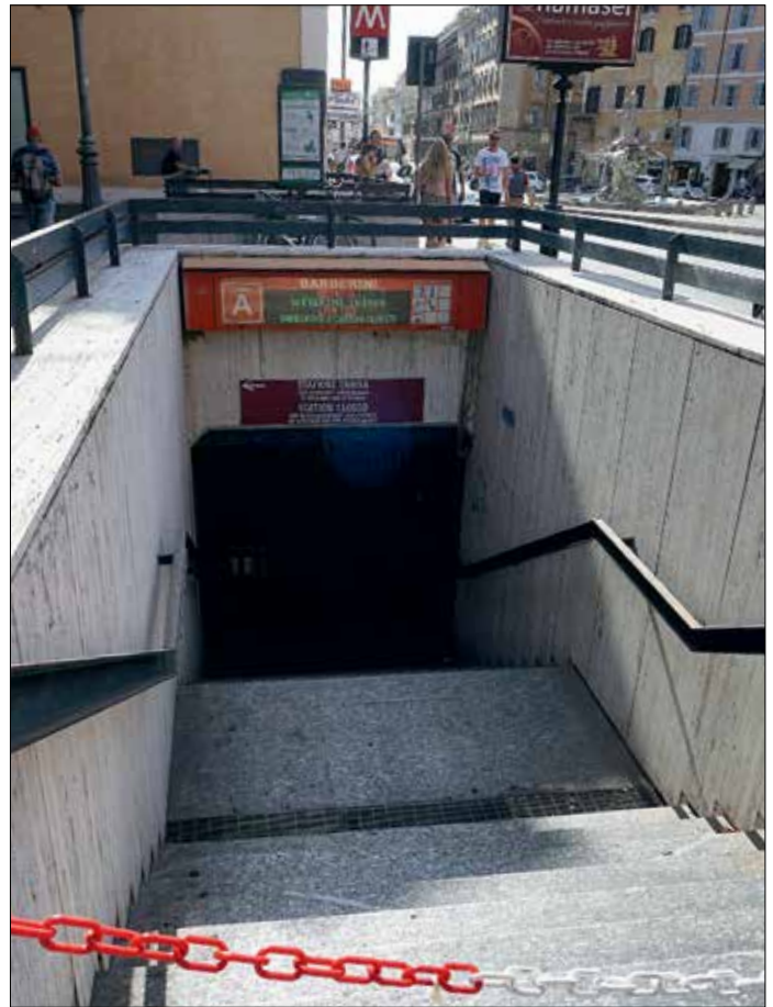
Den 2018 tillfälligtvis avstängda tunnelstationen vid Barberini i Rom, som en följd av havererad rulltrappa. Läs om anledningen i artikeltexten.
