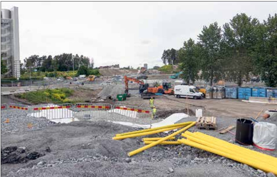
Mellan Rissne och Ursvik ska spårvägen gå på en bro som byggs i denna sträckning, över Enköpingsvägen som skymtar i sänkan i bakgrunden. Till vänster gaveln på SEB:s svängda kontorshus. I maj 2020 revs gång- och cykelbron över Enköpingsvägen. Den nya spårvägsbron kommer att byggas på ungefär samma plats.
